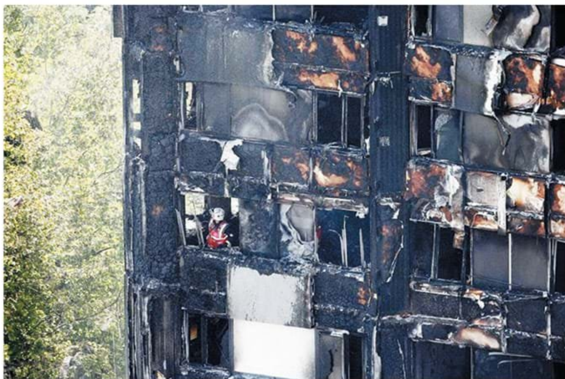
Lực lượng cứu hộ tìm kiếm những gì còn sót lại sau vụ cháy ở chung cư Grenfell. Ảnh: Tư liệu
