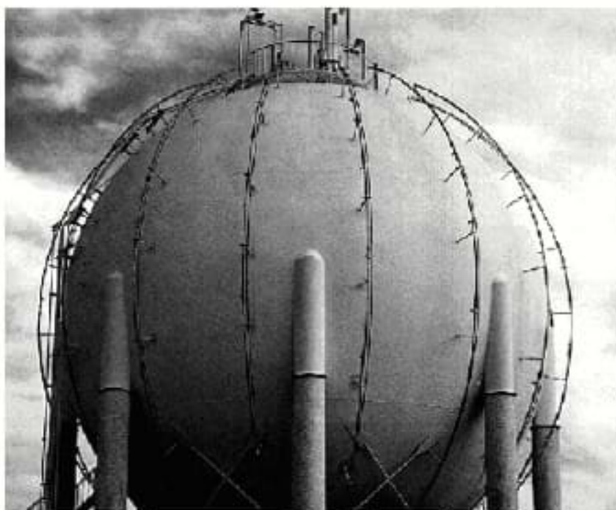
Một số khu vực nguy hiểm cháy cao được lắp đặt hệ thống chữa cháy Hồng Thủy
