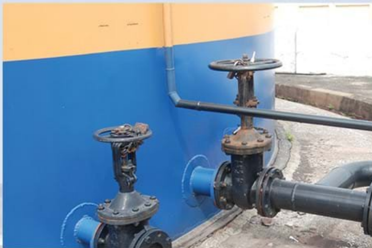
Hình 2. Các khớp nối mặt bích lắp đặt trên đường ống của một bể chứa dầu diesel.
