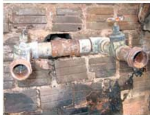
Hình 2: Hiện tượng gỉ sét gây rò rỉ đường ống cấp nước chữa cháy
