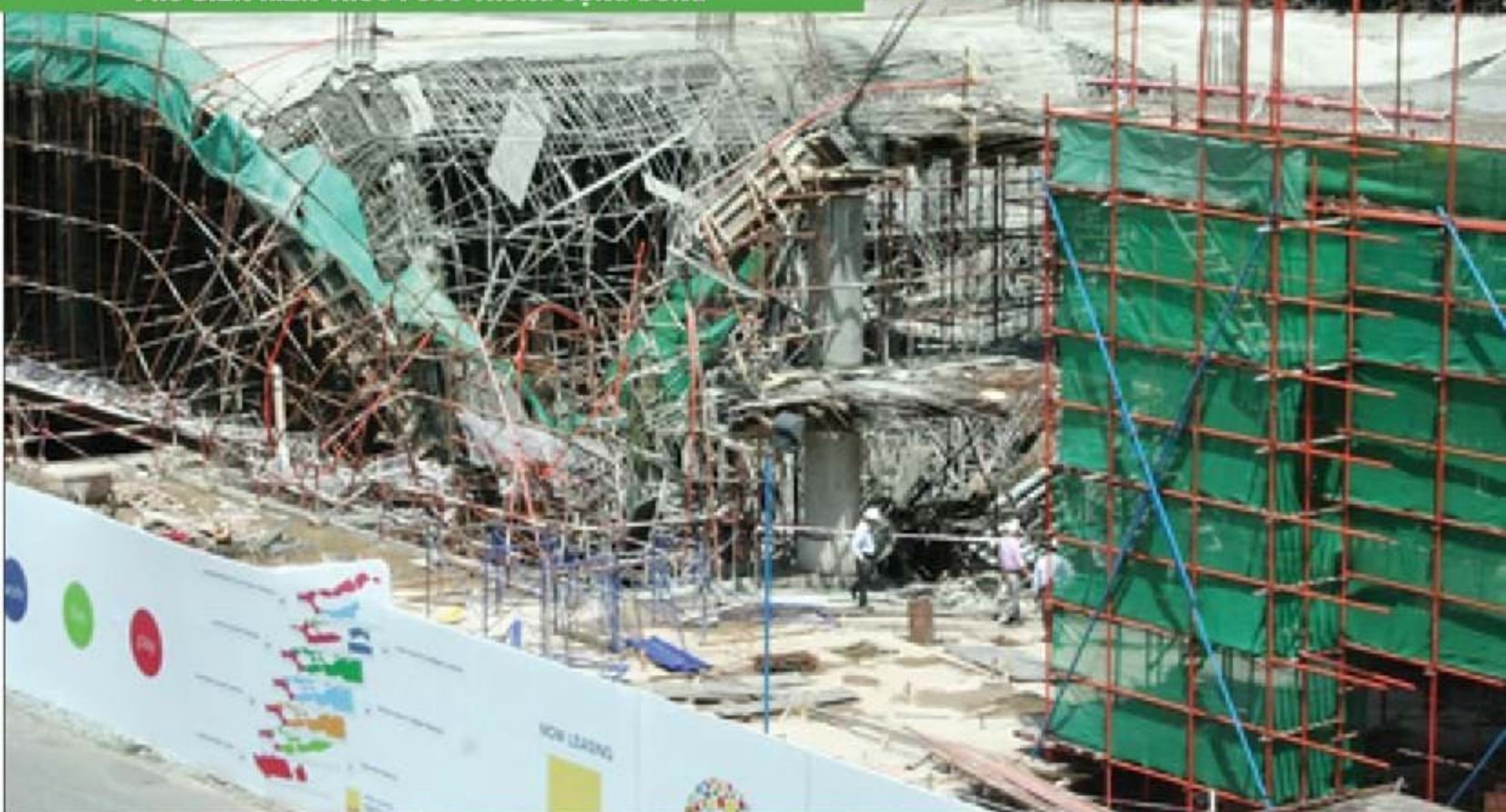
Mảng bê tông khoảng 200m 2 tại tầng một công trình Crescent Mall Shopping (khu đô thị Phú Mỹ Hưng, Q.7, TP.HCM) đang xây dựng bất ngờ đổ sập. Ảnh: Từ An
