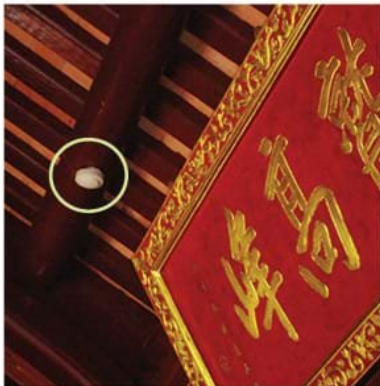
Đầu báo cháy lắp tại Nhà Thái Học Văn Miếu Quốc Tử Giám.
